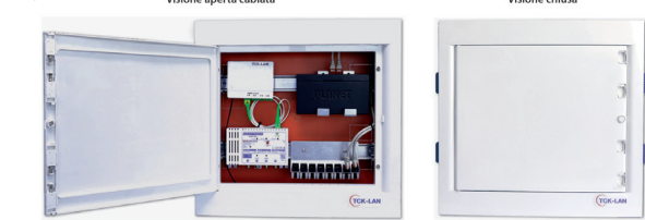
QDSA (esempio di cablaggio)
