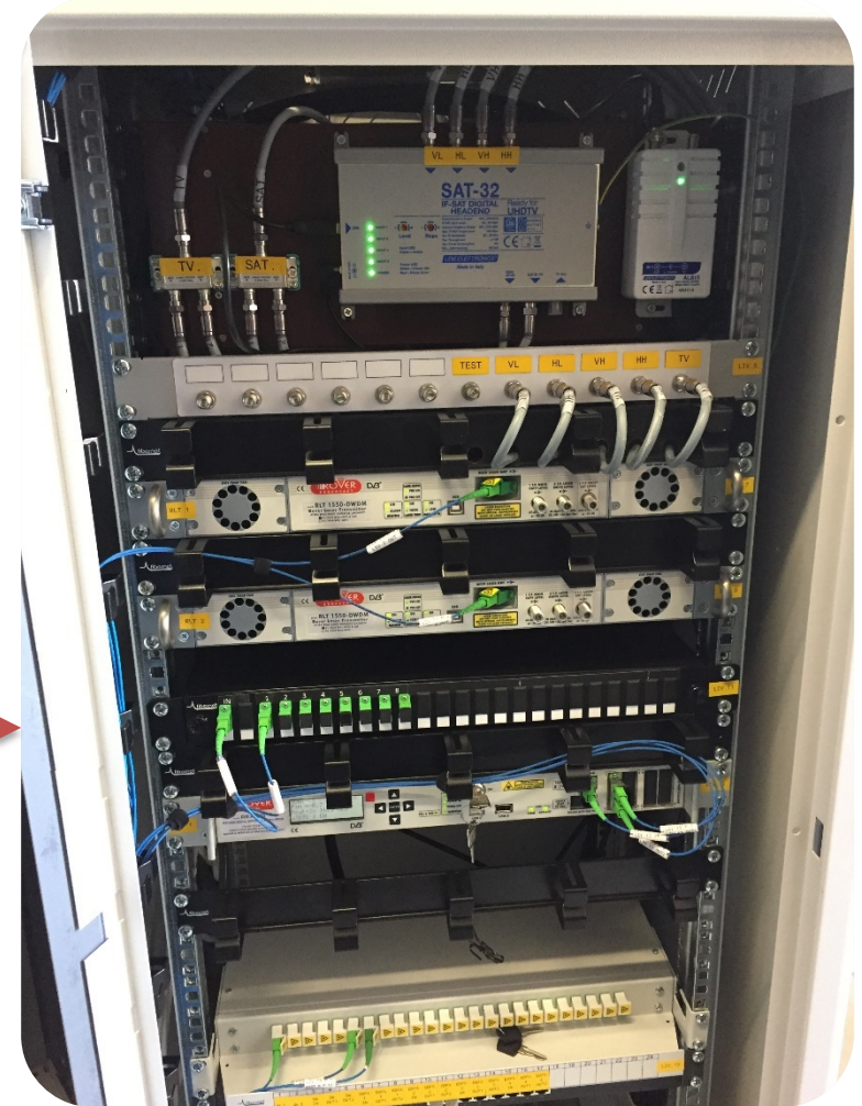
Rack di distribuzione segnale TV - SAT
